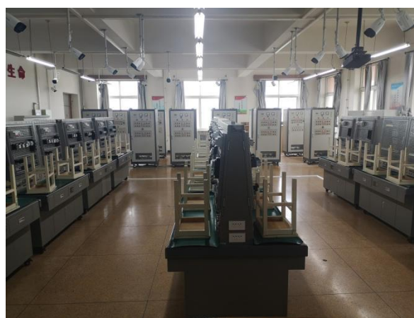
电力拖动实训室
